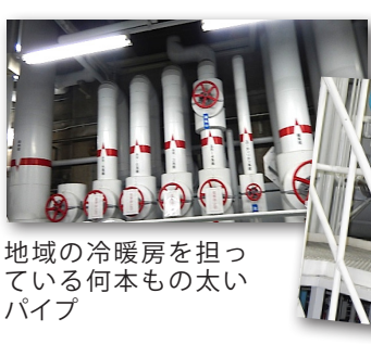
サンシャイン地下の地域冷暖房施設を視察
